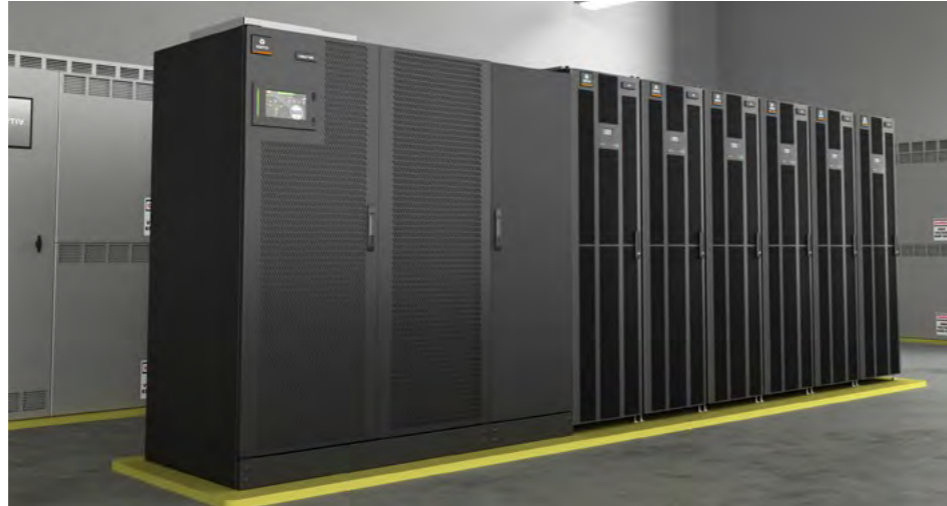
Vertiv™ HPL con batterie agli ioni di litio e UPS Liebert(R) EXL S1 1200kW
