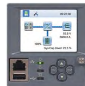
Interfaccia utente dell'unità di controllo NetSure™
