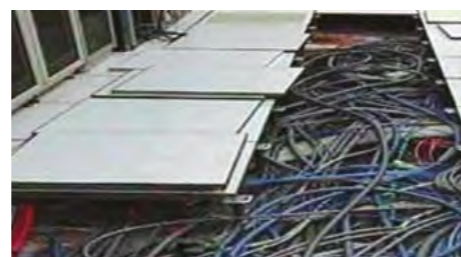
Tipico data center con cavi e condotti di alimentazione
