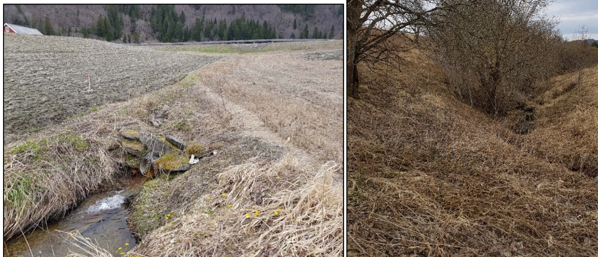
Bilde 4 og 5 – Henholdsvis utløp stikkrenne nedenfor planlagt kulvert, og bekkedal noe lenger nedstrøms
