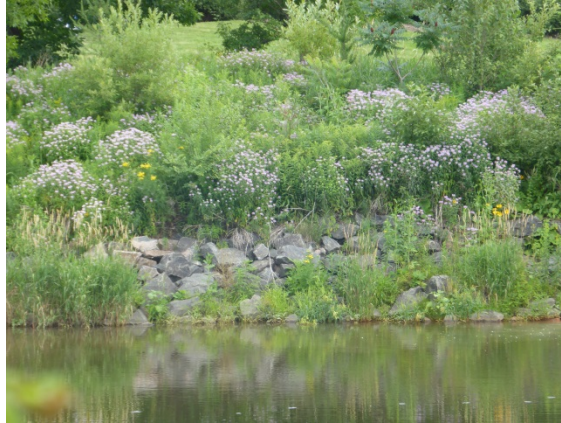
Photo 3.5 Empierrement situé sur la rive-sud de la rivière Saint-Charles, en bordure du pont Lavigueur
