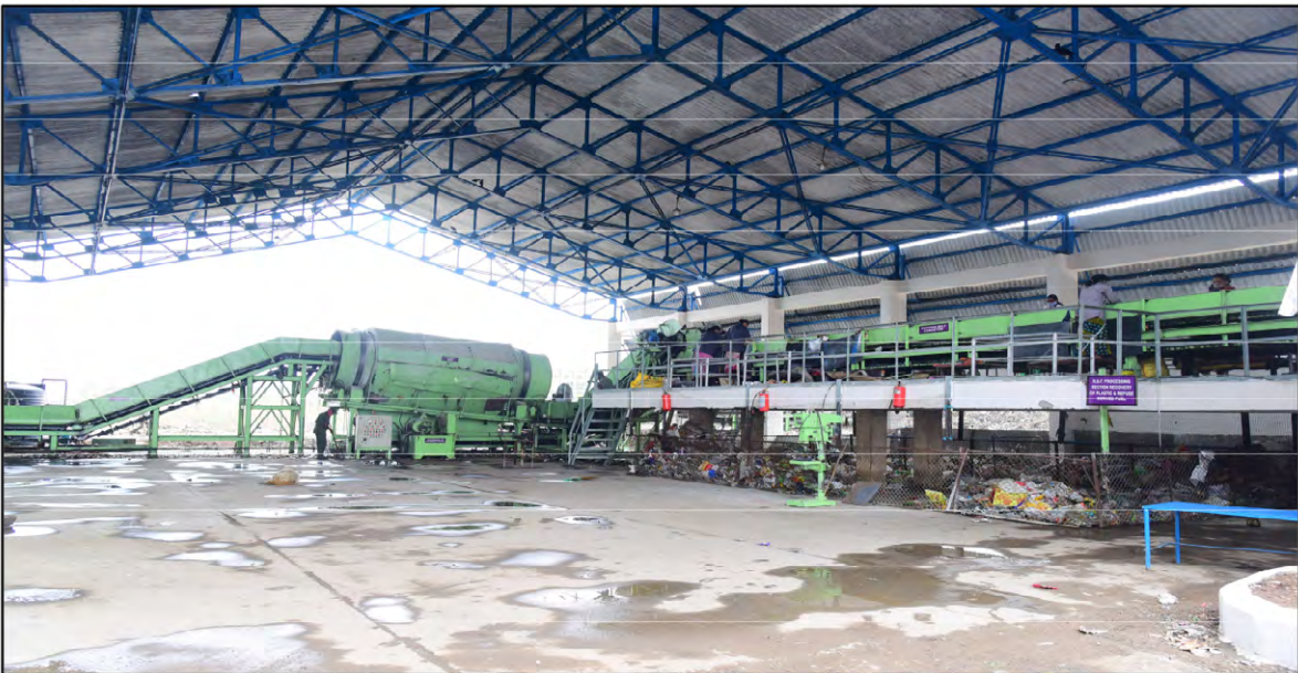
आकृती क्र:३.१२ : मॅकेनिकल कंपोस्टिंग प्लँट
