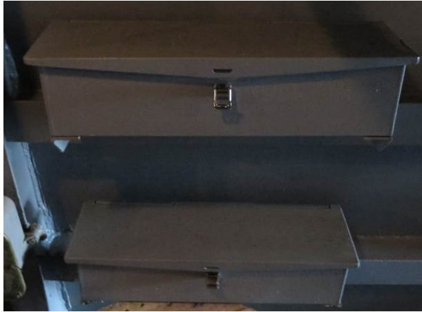
USS BULKELEY (over 2 years installation)
