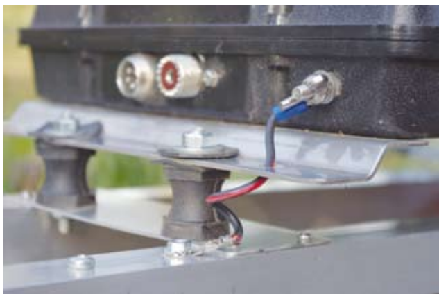
Foto 2 - Attacco dell'accordatore automatico su giunti elastici.
