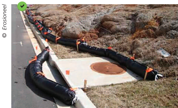
Type 4 : diversion en place pour éviter que l'eau chargée ne rentre dans l'avaloir.
