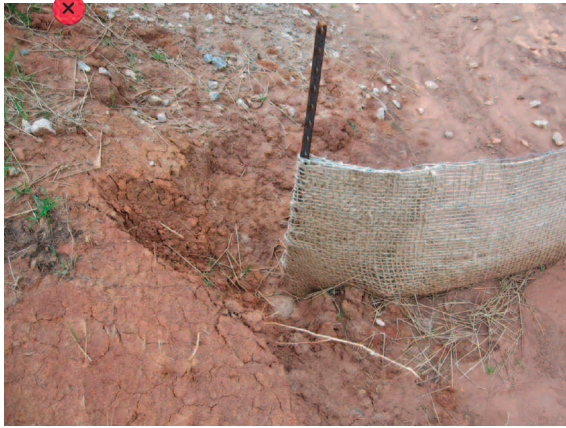
La mauvaise disposition des barrières entraîne des contournements et des processus d'érosion des talus.
