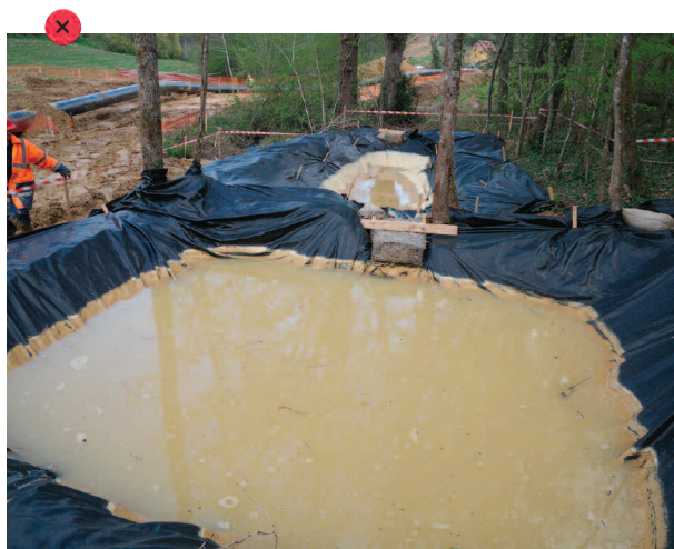
Bassin de décantation inefficace : forme inadaptée ne diminuant pas suffisamment la vitesse du courant et les turbulences hydrauliques.
