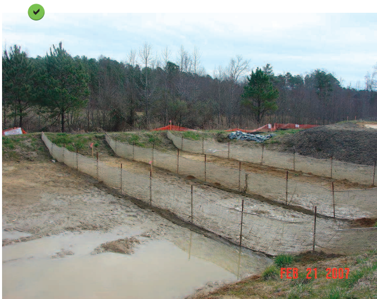
Bassin de décantation équipé de barrières perméables. Une fois le bassin vidangé, les sédiments sont prêts à être curés.
