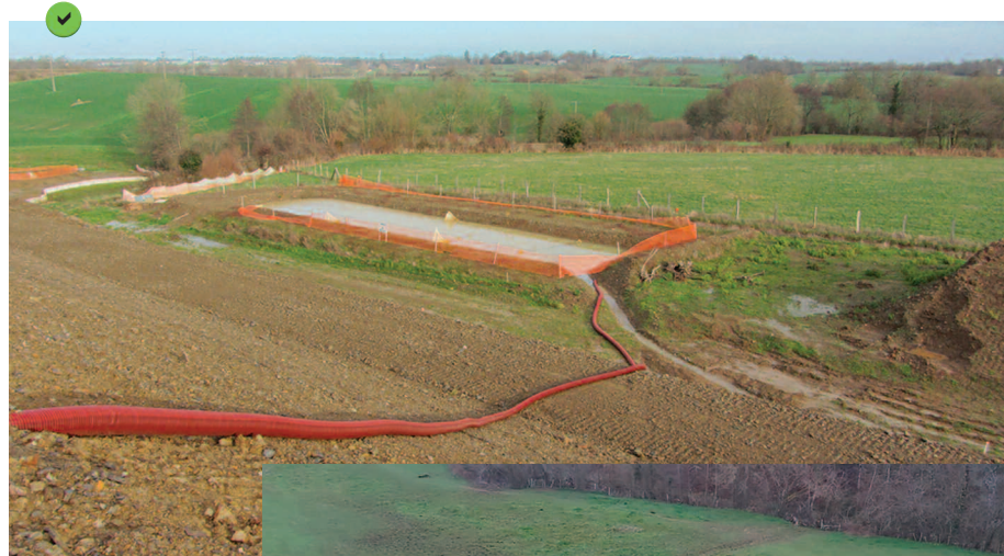
Drain de pente.
