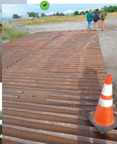
Grille métallique ondulée de protection des accès au chantier.
