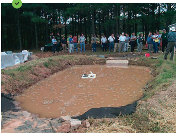
Piège à sédiments avec berges végétalisées.
