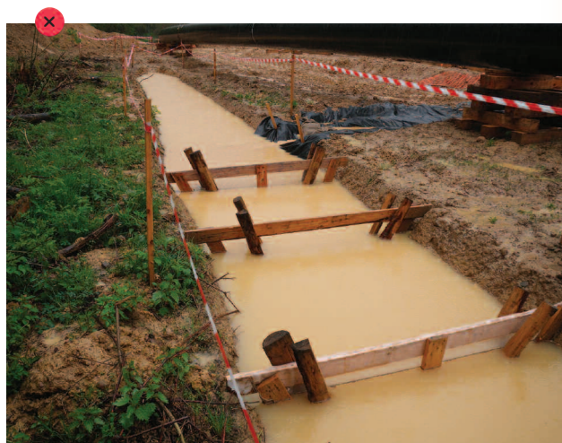
Fossé de décantation inefficace : sur sols très argileux, les particules les plus « fines » ne décantent pas.
