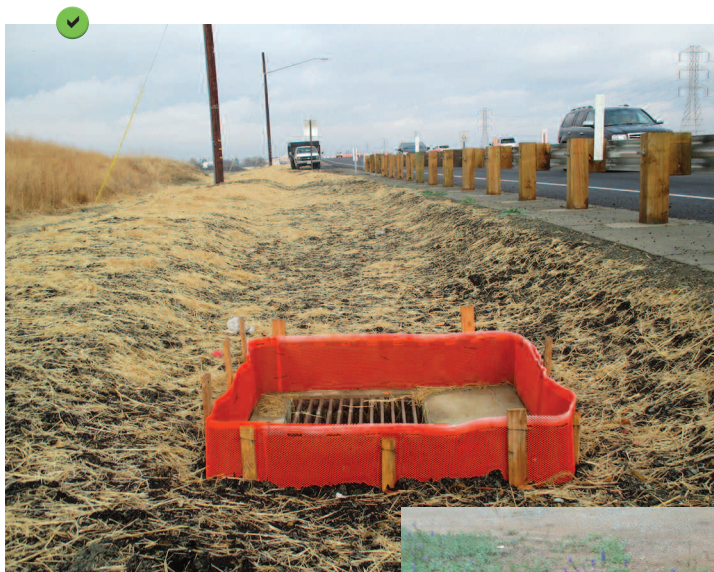
Type 1 : barrière périphérique en toile de géotextile tendue et associée à un paillage du fossé collecteur.
