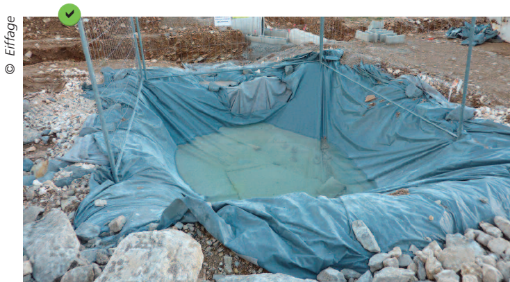
Exemples de fosses étanches de récupération des résidus de nettoyage des goulottes des toupies béton.
