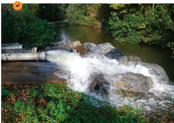
Dispositif temporaire de protection de points de rejet à l'aide d'une plateforme en plats-bords complétée d'un demi-cercle de blocs rocheux de 100 kg à 200 kg. Le choix des dispositifs anti-érosion dépend du débit du point de rejet et des enjeux associés au cours d'eau.
