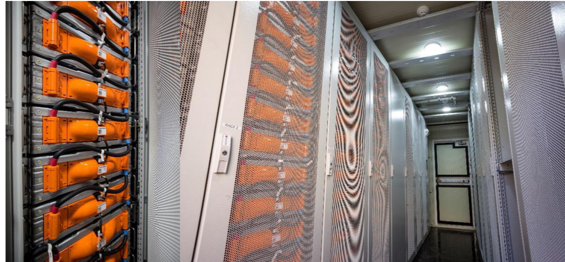
Figure 5 : Batteries Li-Ion de la centrale Leclerc
