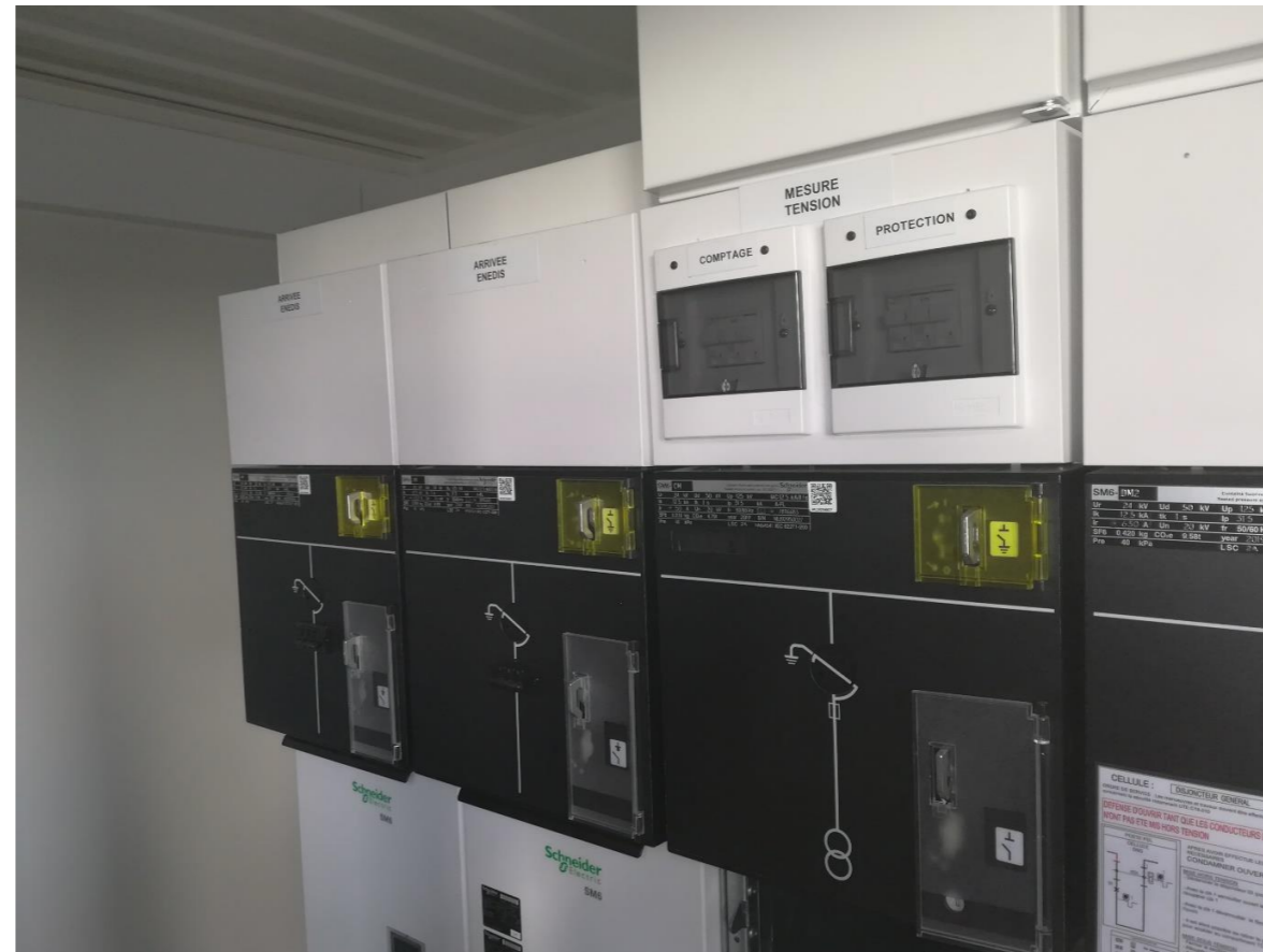
Figure 6 : Container de conversion d'énergie comprenant l'électronique de puissance et le poste HTA
