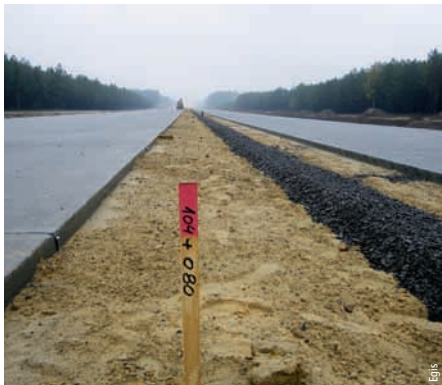
Photos 5 Réseau de drainage dans le terre-plein central Drainage network in median
