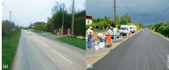
Photos 1 Site expérimental de la RD44 avant (a) et après la mise en œuvre de la grave-émulsion (b) RD 44 experimental site before (a) and after (b) laying of the emulsion treated gravel
