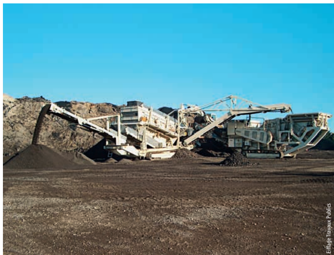
Photo 1 Installation de concassage-criblage d'agrégats d'enrobés (AE) Asphalt aggregate (AE) crushing and screening installation
