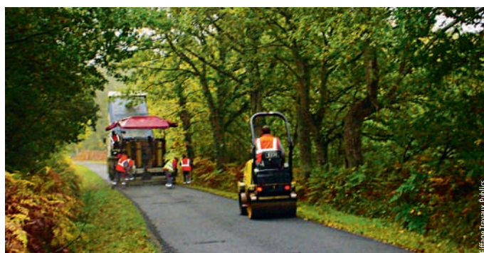
Photo 3 Mise en œuvre de l'enrobé Biocold dans le département de la Sarthe Laydown of Biocold asphalt in Sarthe region
