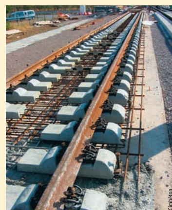
Photo 6 Rails fixés sur traverses béton – Système Rheda Rails set on concrete sleepers – Rheda system
