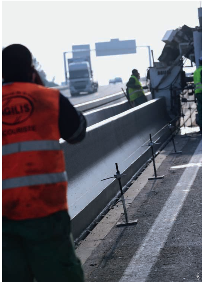
Réalisation d'une GBA en béton extrudé en terre-plein central autoroutier Setup of extruded concrete barrier on motorway median
