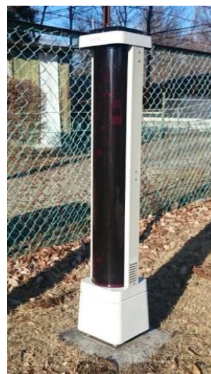
図 3.7 鳥野目浄水場 第一水源沈砂池に設置された 侵入検知センサー
