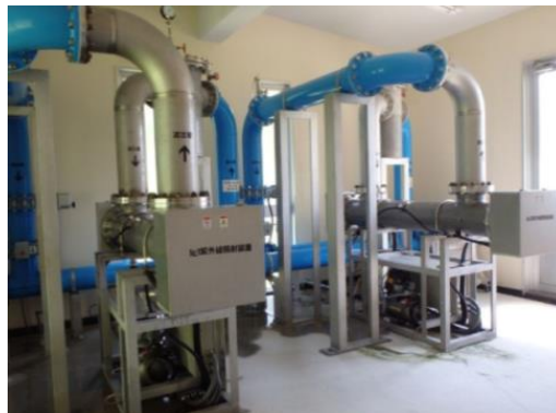
図 3.1 紫外線処理設備（中山配水場）
