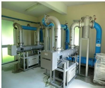
紫外線処理（中山配水場）
