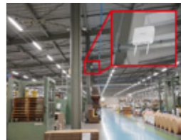
天井高5mの工場上部に設置された「WAPM-1266R」
