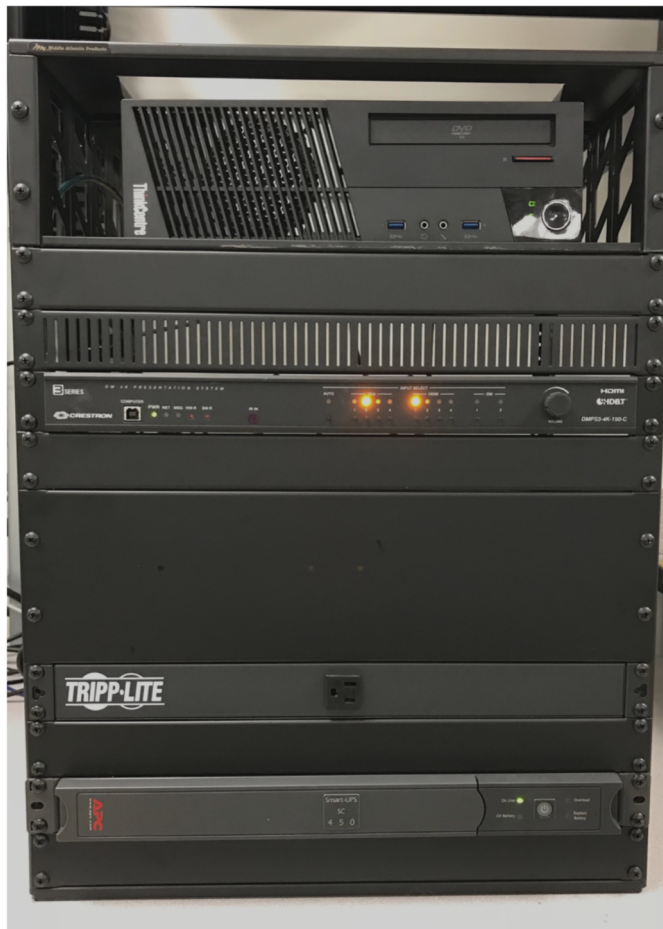
Photo #3 – Podium AV Equipment Rack
