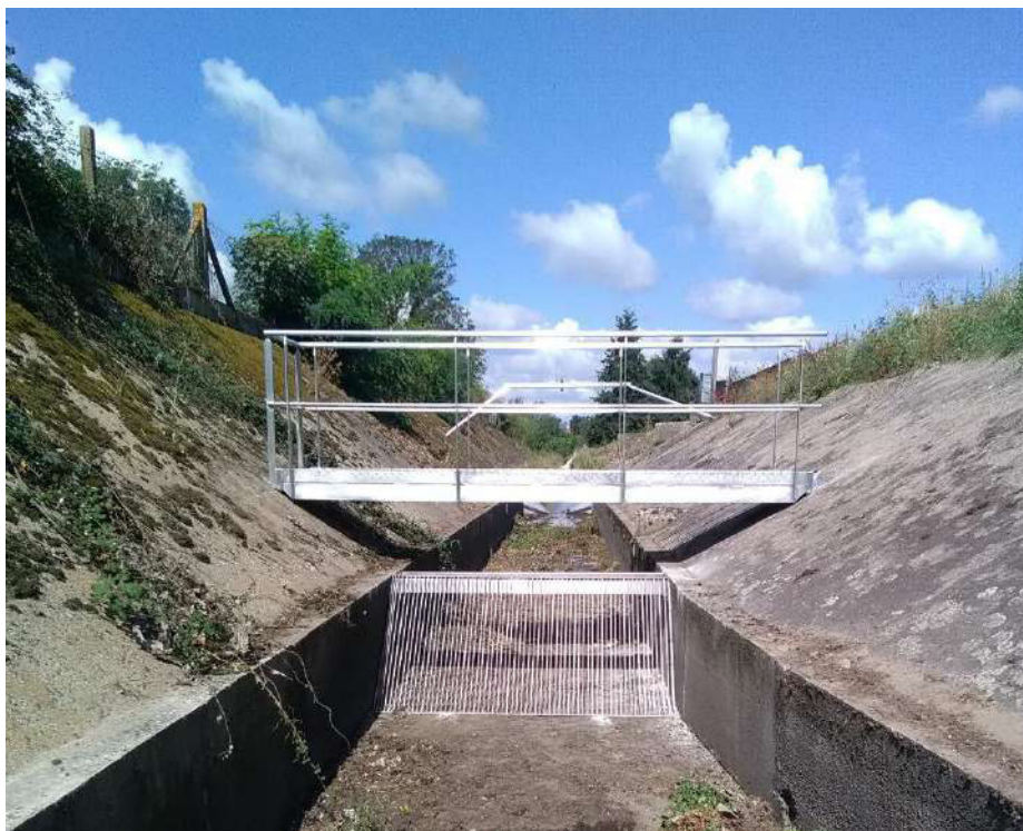
Mise en place d'un dégrilleur sur le by-pass de la STEP des Isles
