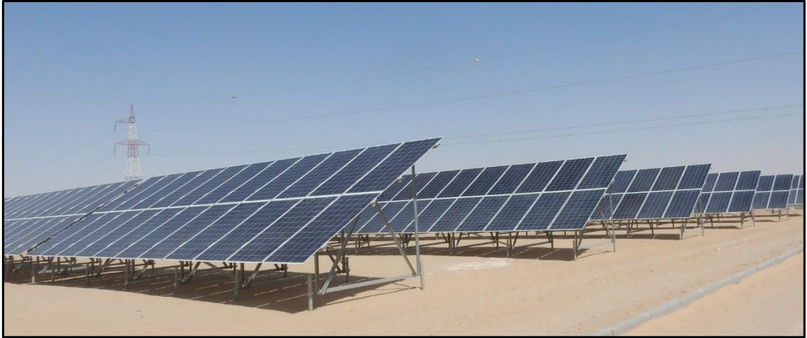
Figure B Exemple d'une rangée de panneaux PV
