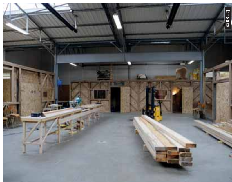
La salle centrale, appelée « la volière ». Les travaux seront terminés en novembre.
