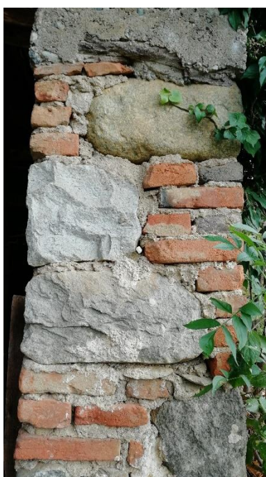
Foto 4.11 – Particolare pilastro con interposizione di grosse pietre e mattoni pieni.
