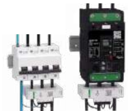
Contoh Pemasangan PowerTag Flex 160 A
