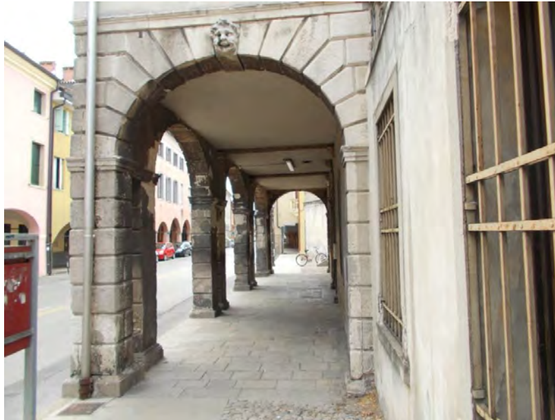
Figura 4.07 Degrado sul portico esterno
