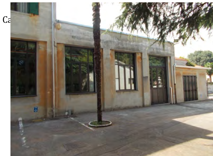
Figura 4.06 Degrado sulla facciata del laboratorio
