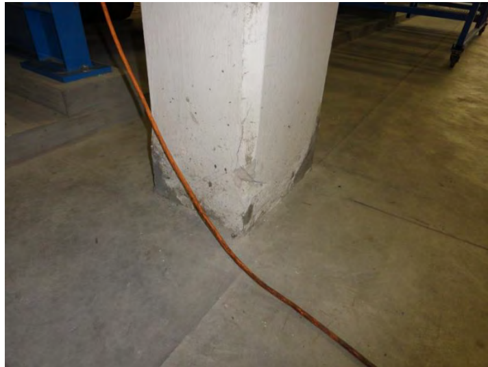
Figura 4.10 Espulsione di materiale, pilastro del laboratorio
