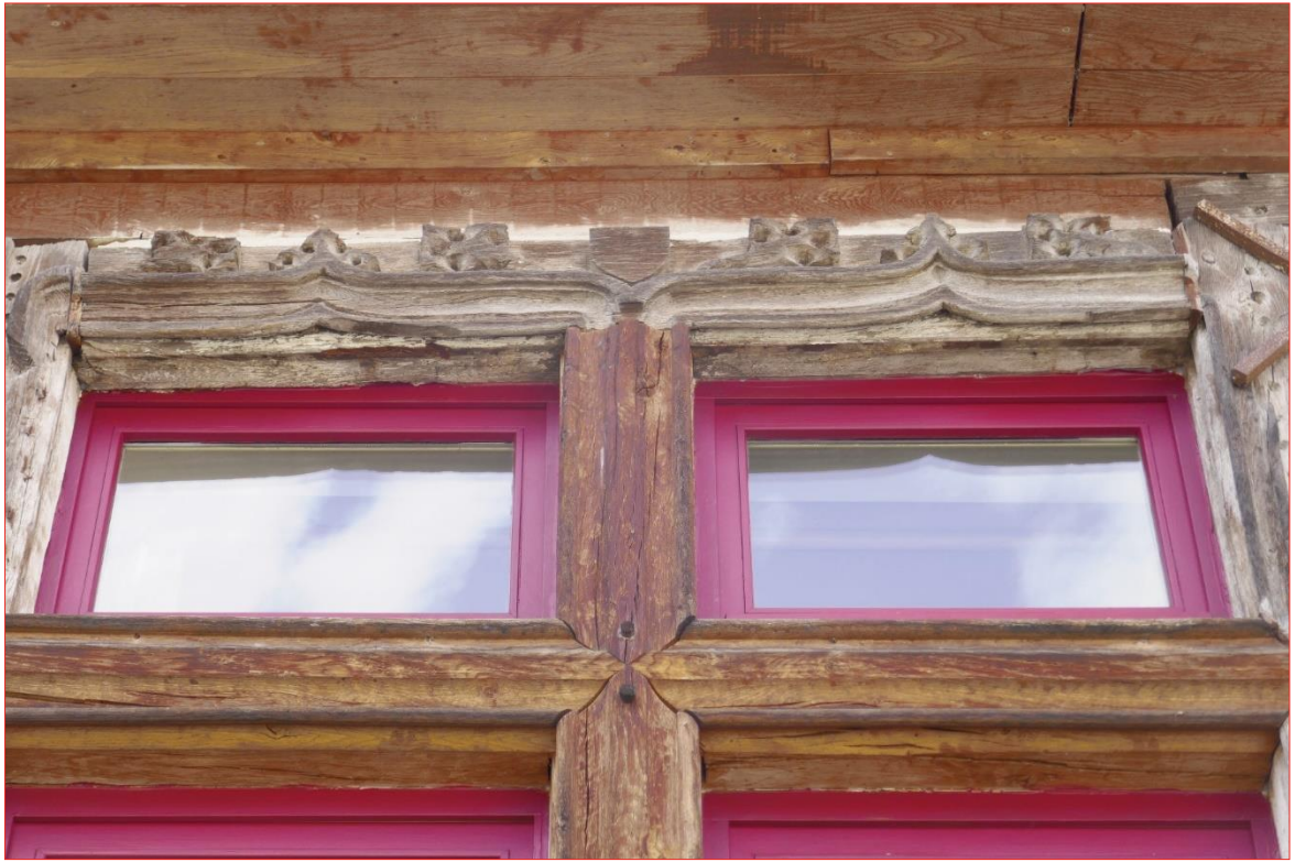
Photo 17 : Détail du linteau sculpté de la fenêtre à croisée. Le meneau et la traverse ont été remplacés – maison nord
