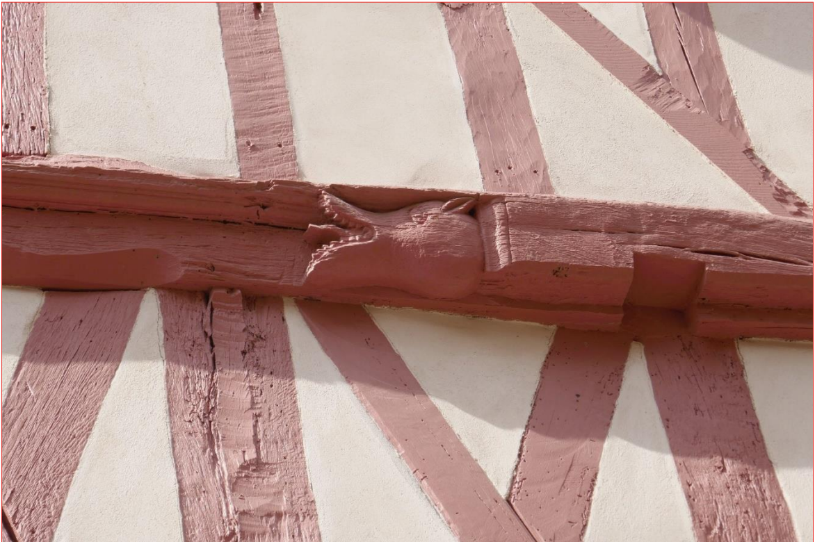
Photo 3 (en haut) : Pinacles buchés sur les poteaux du pan de bois de l'étage - façade sud. Photo 4 (en bas) : Sablière à engoulent, extrémité est - façade sud.
