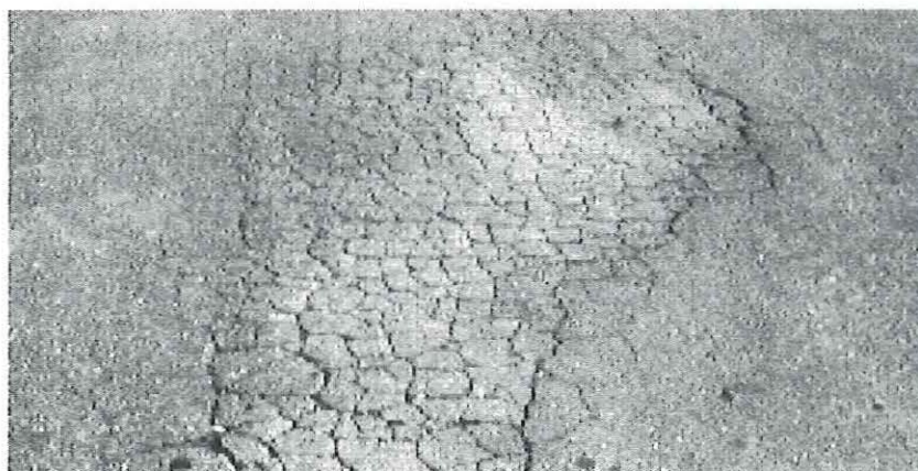
FIGURA 1.1 - Trincas por fadiga do revestimento asfáltico (Fonte: FERNANDES, JR. et al. , 1999)
