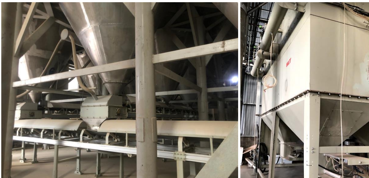
Hình 3. 6: Hệ thống xử lý bụi băng tải, silo bột của nhà máy hiện hữu
