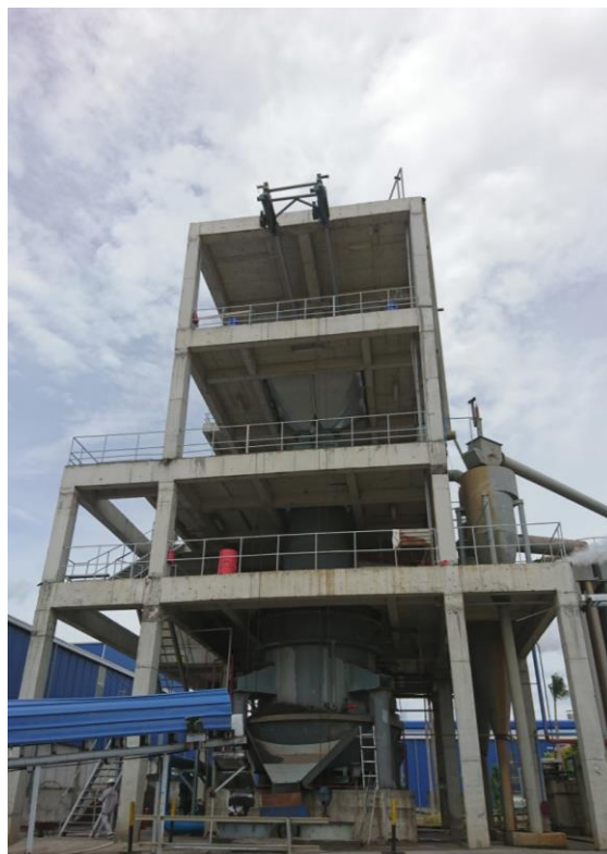
Hình 3. 20: Lò khí hóa than giai đoạn hiện hữu đã lắp đặt
