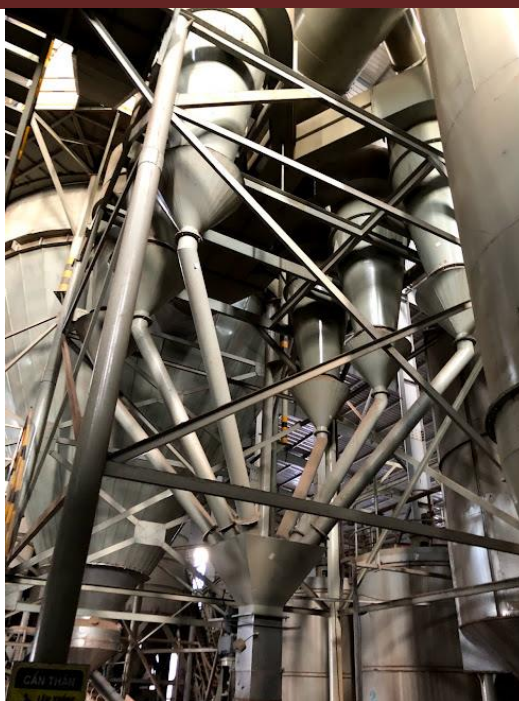
Hình 3. 10: Hệ thống xử lý khí thải tại lò sấy phun
