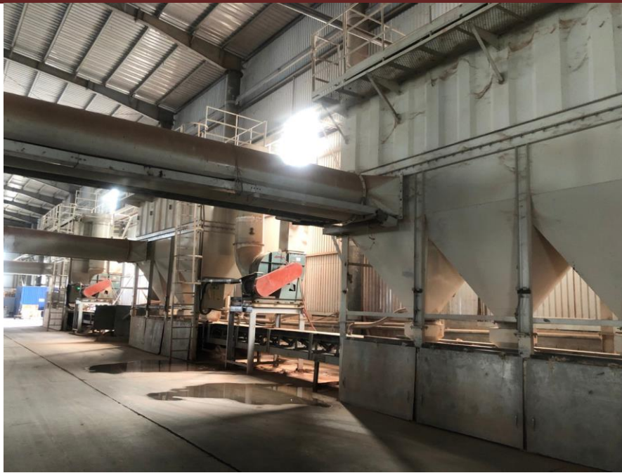
Hình 3. 14: Thiết bị xử lý bụi từ công đoạn đóng gói tại nhà máy hiện hữu
