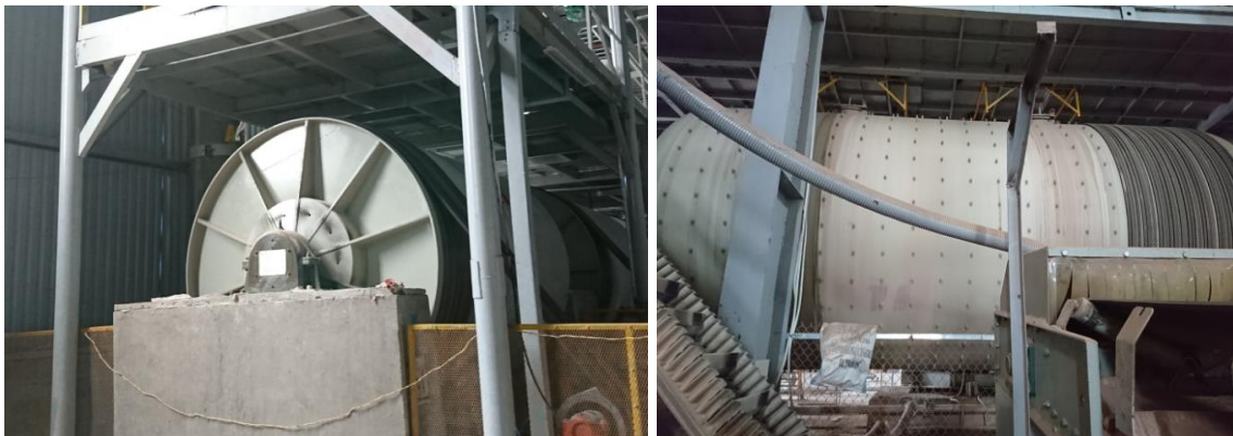
Hình 3. 7: Hình ảnh máy nghiền nguyên liệu tại nhà máy hiện hữu (máy kín hoàn toàn)
