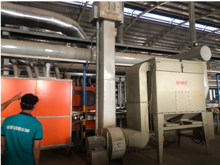
Hình 3. 12: Thiết bị xử lý bụi mài mặt gạch tại nhà máy hiện hữu
