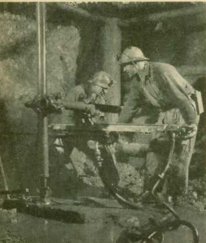
Dans les riches dépôts d'argent-plomb-zinc de la région de Mayo, au Yukon, des foreurs percent des trous à poudre de telle manière que la pierre éclatera sans endommager les étais.
