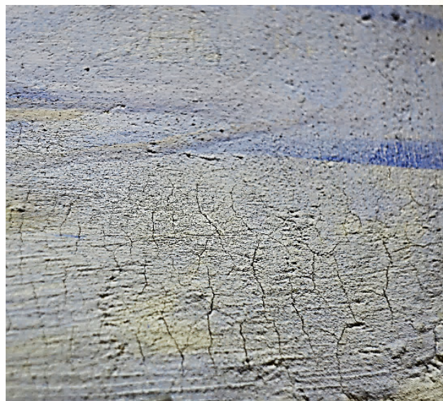
Фото 4 Трещины на поверхности грунта на жидком стекле из-за малого количества наполнителя и слабой затирки поверхности
