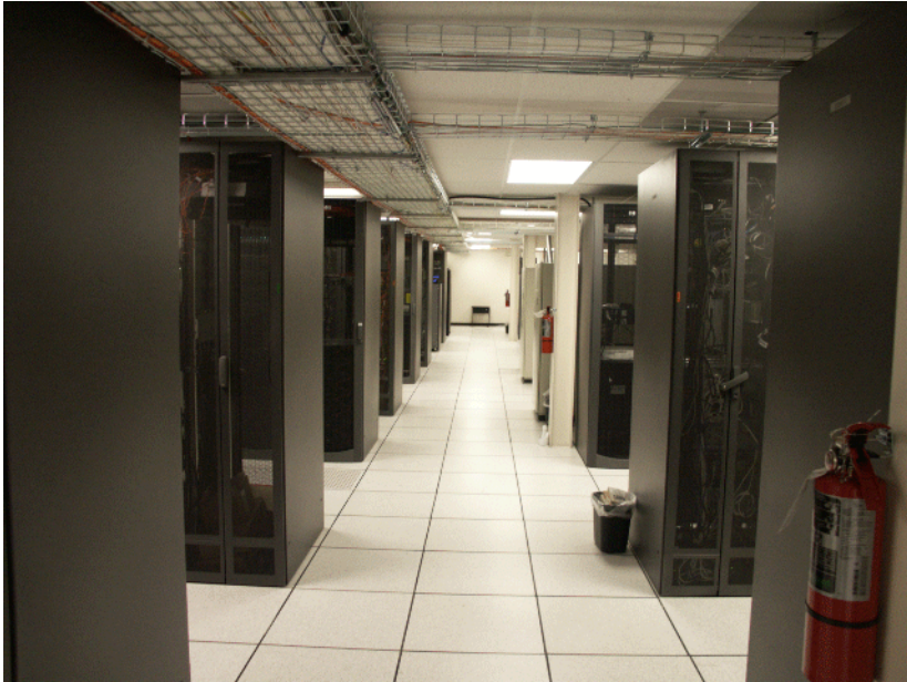
FIGURE 20.3 – Un datacenter, dans lequel on voit plusieurs baies de serveurs
