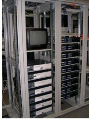
FIGURE 20.2 – Une baie de serveurs
