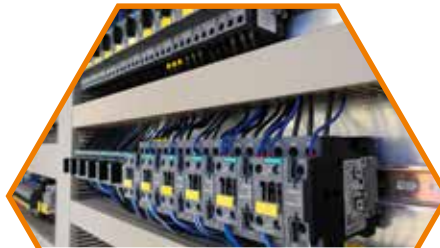
Installateurs Intégrateurs Tableautiers
