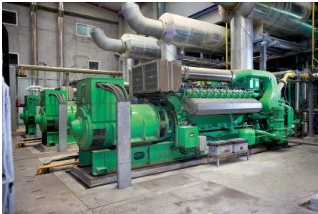
Loiolako HUAko kogenerazio- motorrak. Motores de cogeneración en la EDAR de Loiola.
