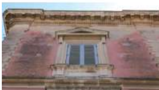
Fig. 7 - Disgregazione, patina biologica, alterazione cromatica e rifacimentid'accesso
