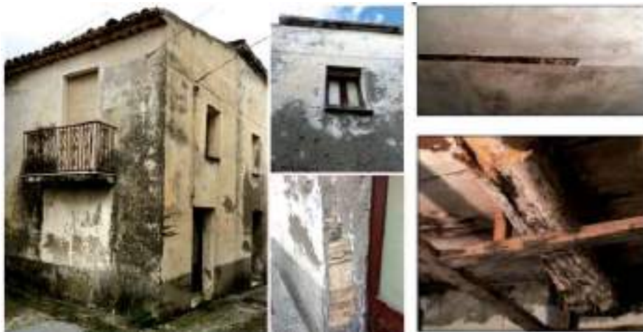
Fig. 2 – Rilievo fotografico e degrado dei materiali
