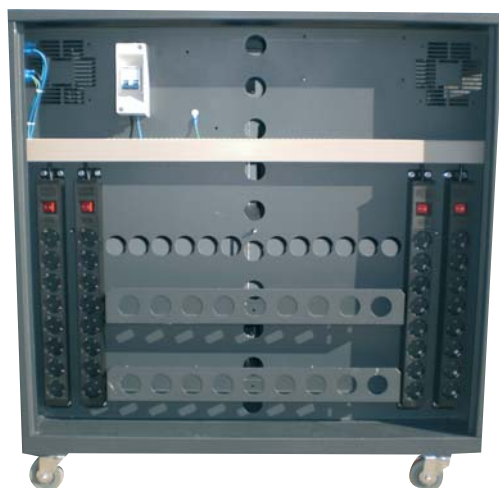
Instalação eléctrica dedicada, com acesso restrito, bandejas para os carregadores com fechadura de chave
