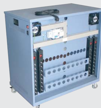
Instalação eléctrica dedicada, com acesso restringido com cadeado de chave
