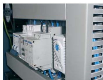
Ventiladores e carga sequencial nos dois circuitos, com termostato e relógio
