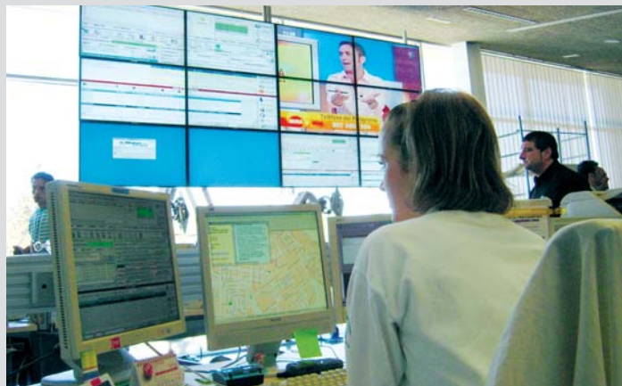
Controlo de sala e informação AV
