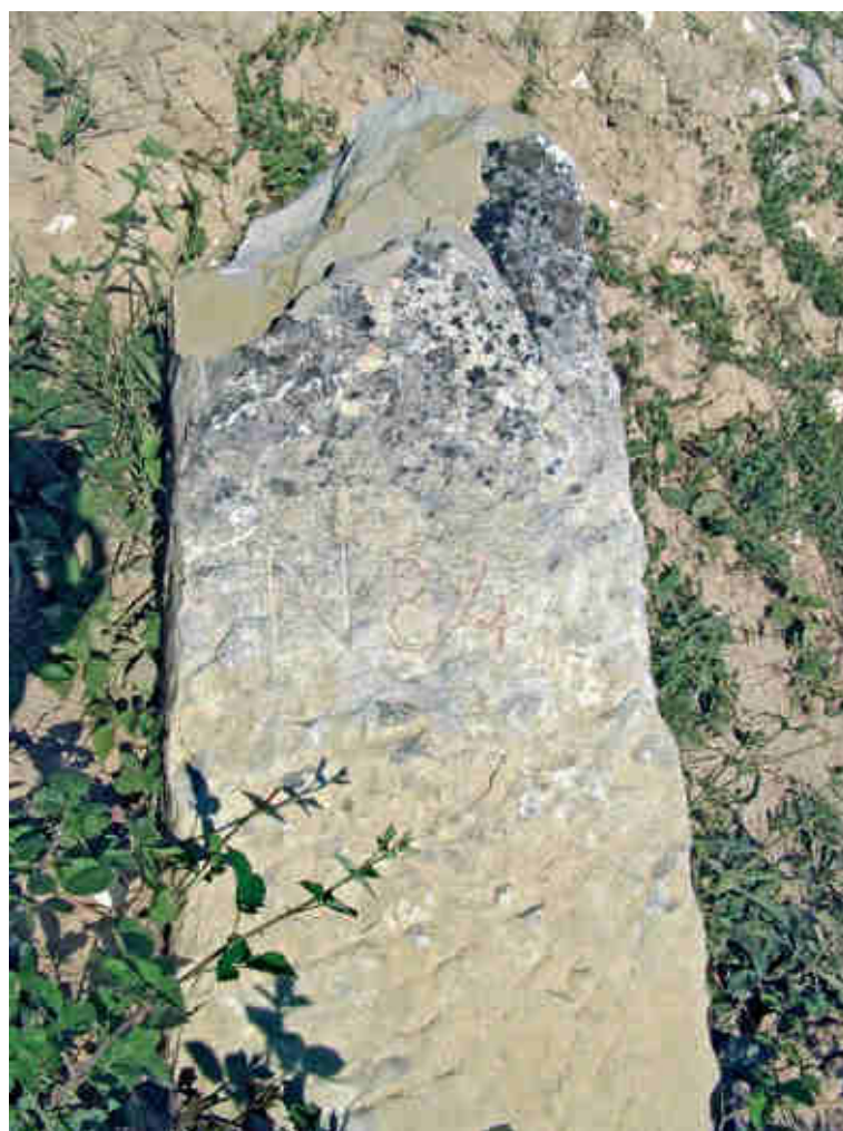
Fotografija graničnog kamena na terenu nakon nastanka oštećenja. Fotografia del termine sul campo dopo il danno subito.
