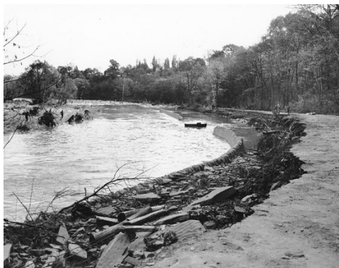
FIGURE 5 – Erosion des berges d'une rivière
