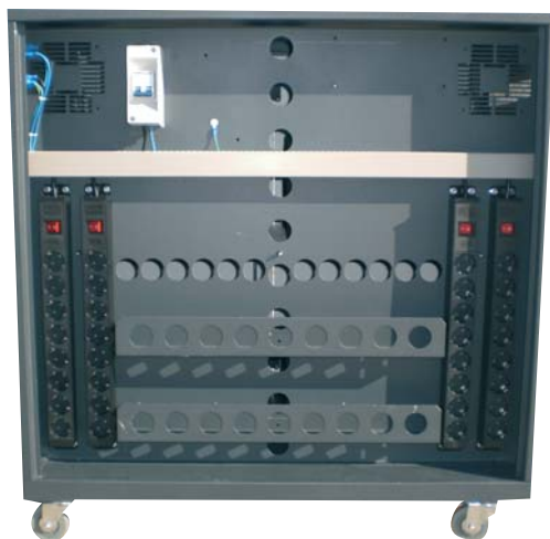
Instalación eléctrica dedicada, con acceso restringido, bandejas para los cargadores con cierre de llave
