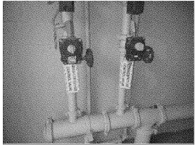
86. Fire sprinkler riser
