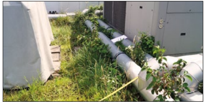
Abb. 14: Rückzugsorte zwischen Kühl- und Lüftungsvorrich- tungen Foto: Gregor Auinger
