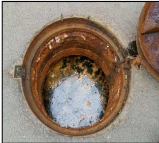
Bâche de sulfate ferreux
