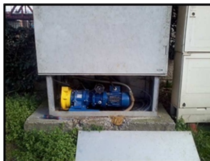
Pompe à sulfate
