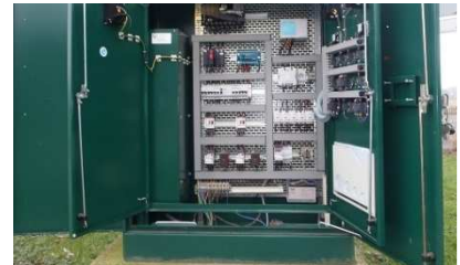
Poste de relèvement
