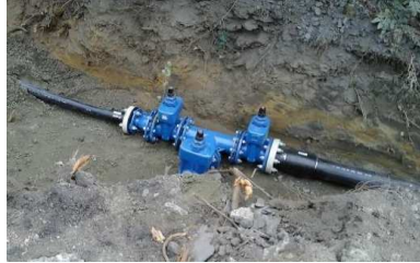
Réseau eau potable
