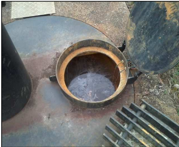
Bâche de sulfate ferreux
