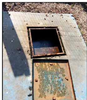
Bâche de sulfate ferreux
