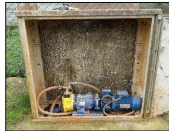
Pompe à sulfate
