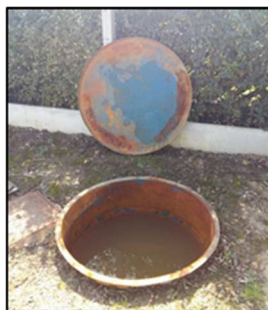
Bâche de sulfate ferreux
