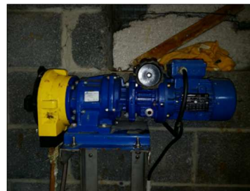
Pompe à sulfate
