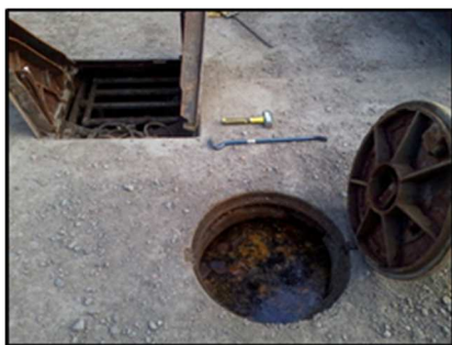
Bâche de sulfate ferreux
