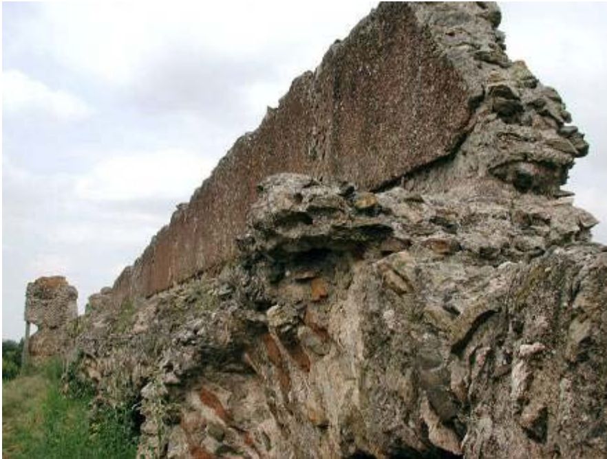
Revêtement d' opus signinum vu dans l'un des piédroits abîmés de l'aqueduc du Gier (Lyon).
