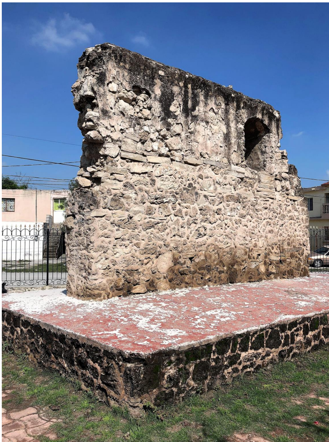
Muro de lo que fuera la capilla de La Purísima Concepción, ubicada al poniente de la Alameda de El Pueblo, Monclova, Coah. Probablemente fue construida cuando don Antonio Balcárcel Rivadeneira y Sotomayor fundara la villa de Nuestra Señora de Guadalupe, hoy Monclova.
