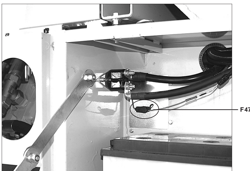
fusible F47 dans le compartiment à batteries
