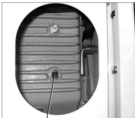
fenêtre de contrôle
