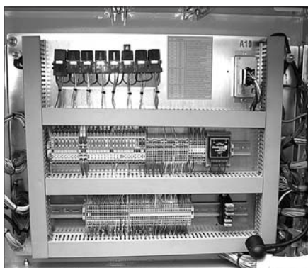
armoires de commande de la centrale électrique
