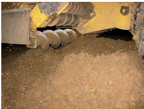
Ici la hauteur maximale du tas de terre est atteinte. La machine doit maintenant être déplacée.
