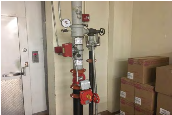
#59 FIRE SPRINKLER RISER
