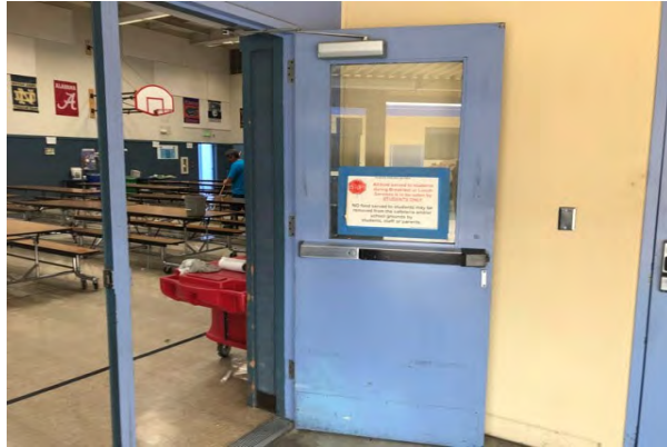
#25 EXTERIOR STEEL, DOOR
