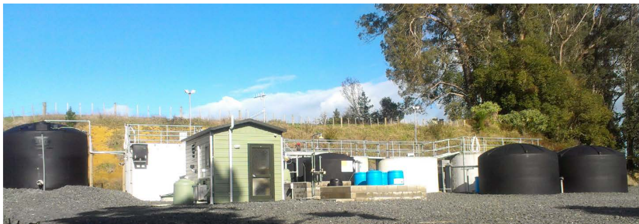
Tahuna Treatment Plant
