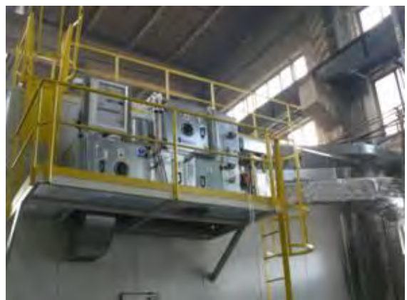
Obr. 2 Klimatizační jednotka laboratoře umístěná na stěně vestavku Fig. 2 Air conditioner of laboratory located on the wall-building
