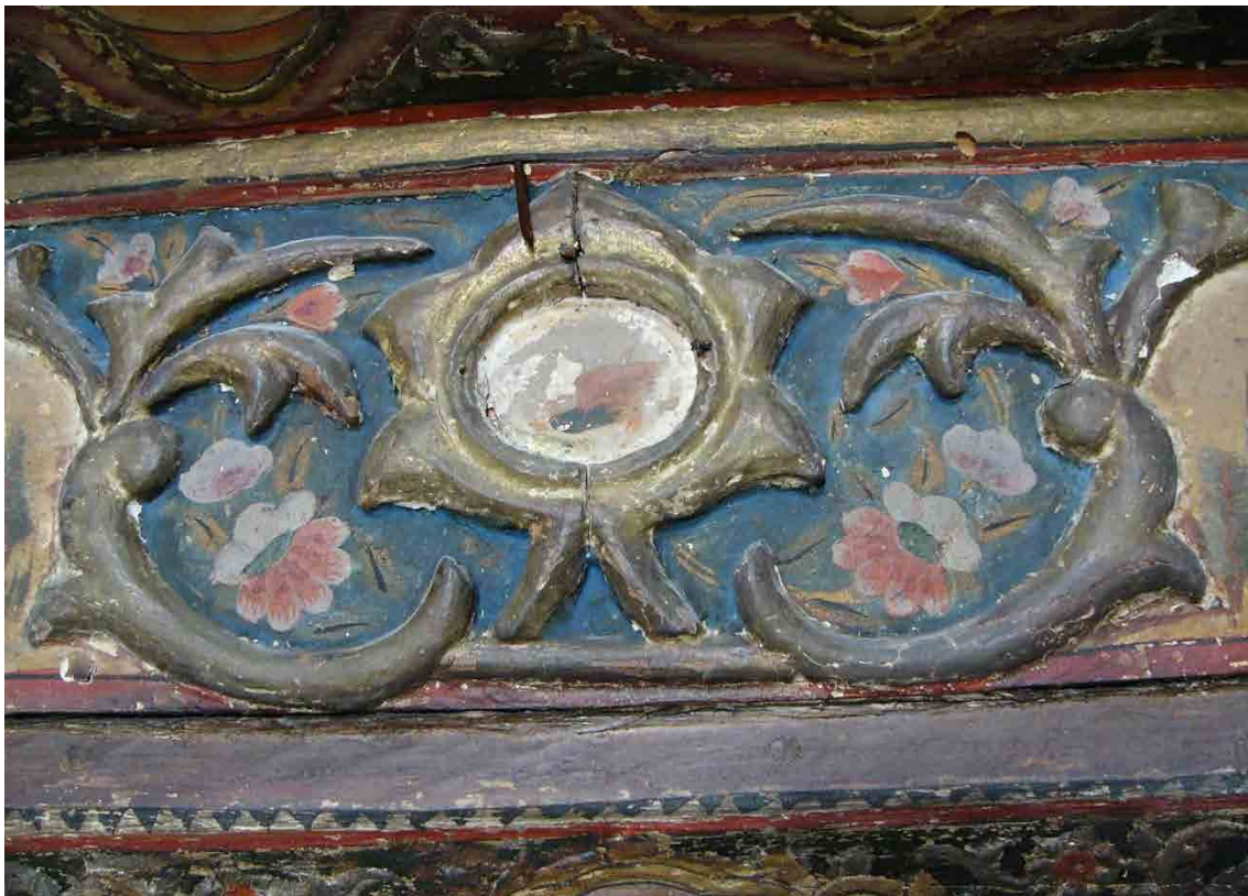
Abb. 680: Originale Bemalung des ṭazar -Wandvertäfelungsgesimses aus dem Raum östlich des īwān im westlichen barrānī , fotografiert vor der Übermalung 2007
