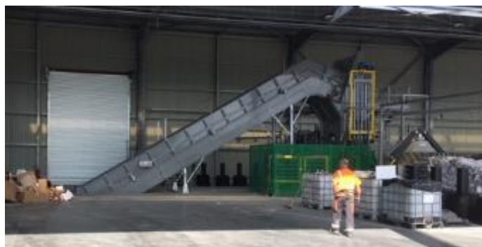
Zone de mise en balles (presse)
