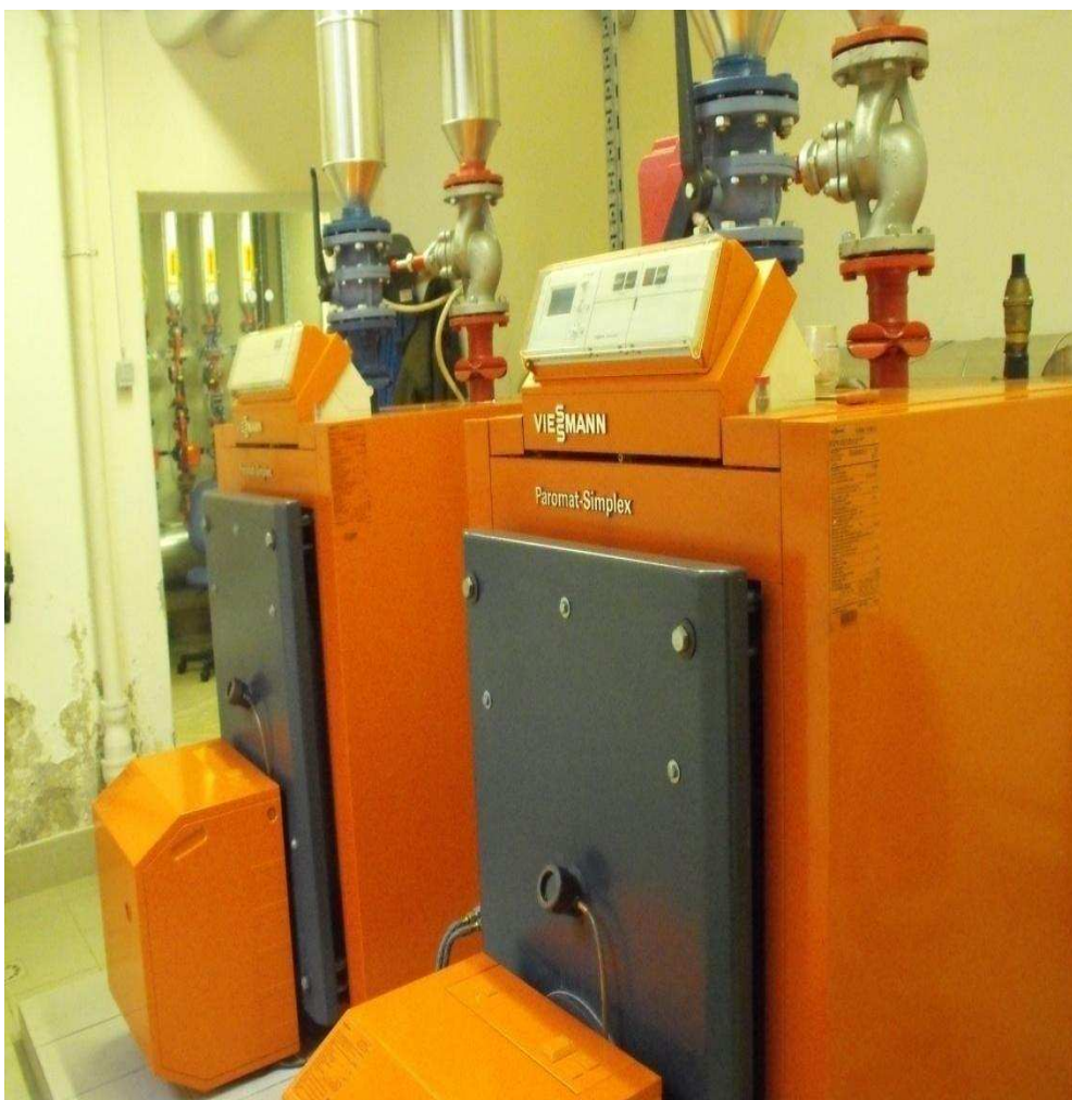
Slika 15: Kotlovnica enega večjega uporabnika
