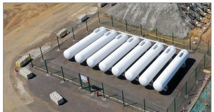
Figure 5 : Photo du parc à cuves
