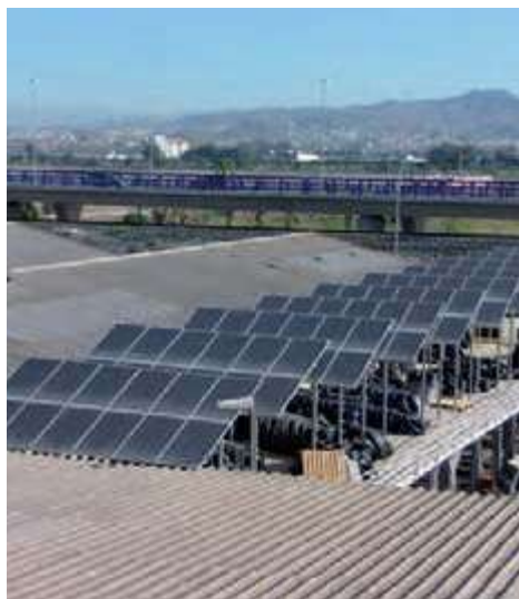
INSTALACIÓN FOTOVOLTAICA DE LA DELEGACIÓN DE BAEZA MÁLAGA
