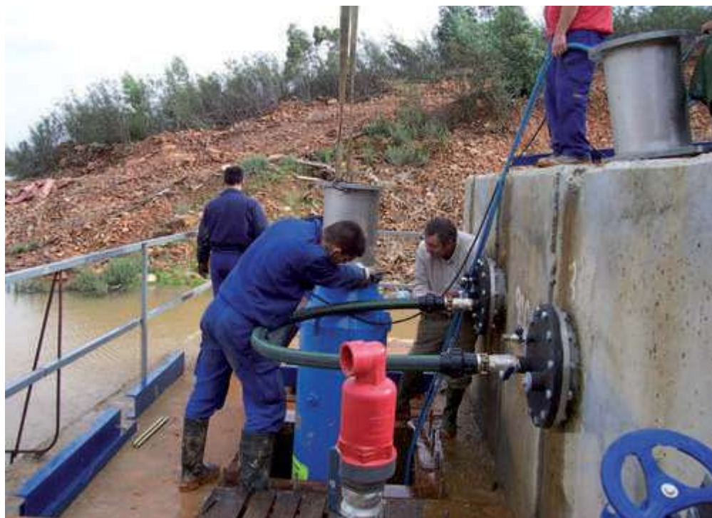
Instalación de bombas sumergibles.
