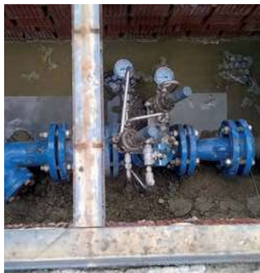
Reductora y sostenedora
