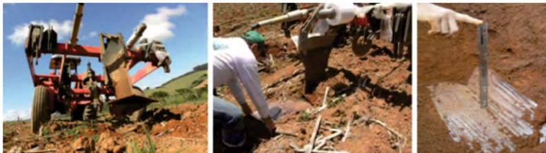
Figura 2– Subsolador para introduzir manta plástica (esquerda); Introdução de manta plástica (centro); Manta plástica forma de calha em “V” dentro do perfil de solo (direita).
