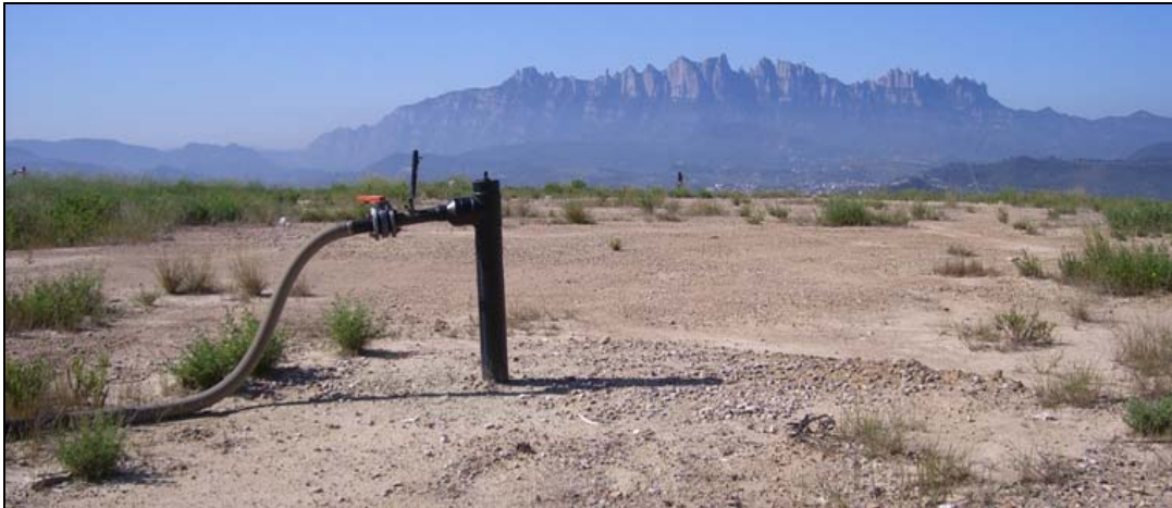
Figura 4.1: Pozo de lixiviado
