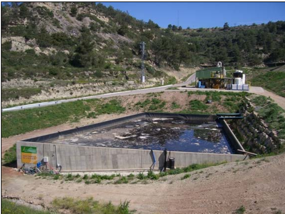
Figura 4.2: Planta de tratamiento de lixiviados
