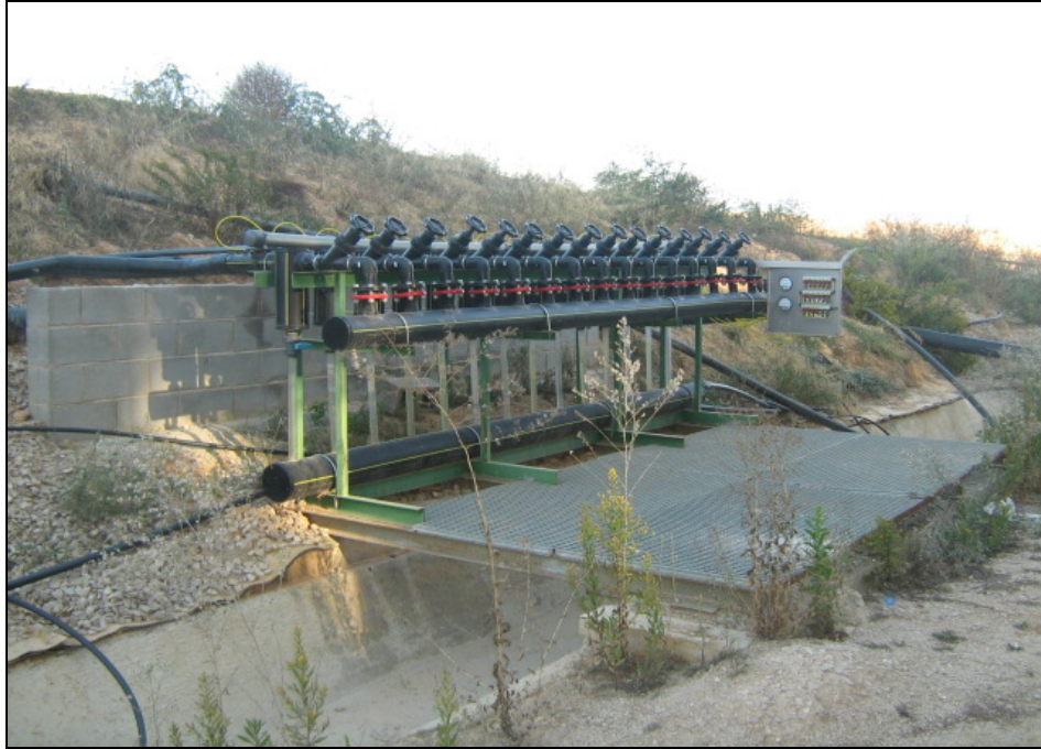
Figura 4.3: Estación de biogás
