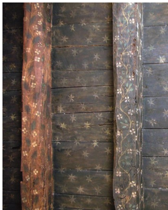
FIG. 22. RINCEAU FLEURI DÉCORANT LES SOLIVES D'UN PLAFOND DE LA MAISON DE LA PLACE DES CONQUES À VILLENEUVE-D'AVEYRON, Cliché Ch. Évrard, ABR.
