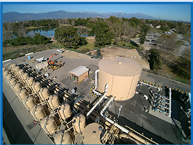
Sistema de tratamiento de aguas subterráneas de la OU Whittier Narrows.
