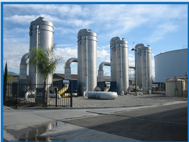
Sistema de tratamiento de aguas subterráneas en uno de los cinco sistemas de tratamiento de la OU Baldwin Park.
