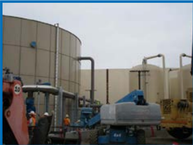
Construcción de la planta de tratamiento de la Zona intermedia de la OU Puente Valley, City of Industry.
