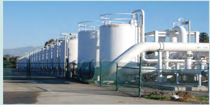
Sistema de tratamiento de agua de la unidad operable Whittier Narrows
